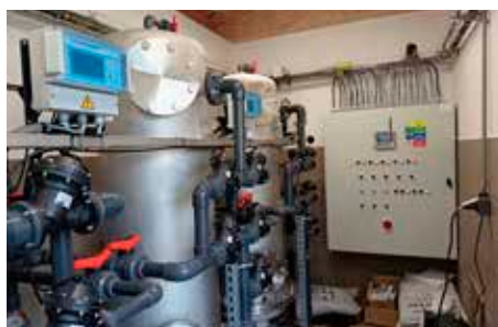
Úprava vody Č. O.
